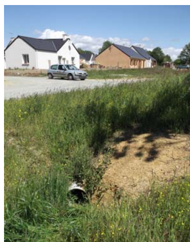
Vue du Φ400 PVC en entrée ( connexion avec le bassin en amont )
